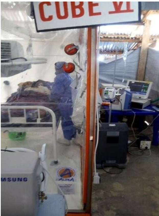
Figure 2: chambres individuelles et couloir de bas risque permettant d'accéder au patient: CTE
